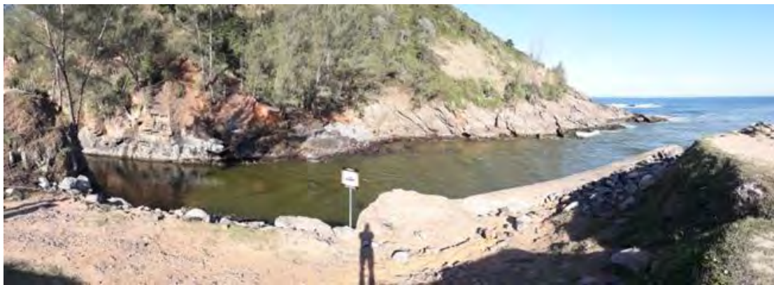
(13) Abertura do Canal de Ponta Negra com provável rompimento de laje. No entanto, o escoamento é aparentemente desimpedido, suficiente para escoar a água da Lagoa para o mar e vice-versa. Fonte: IBAM, 2020.
