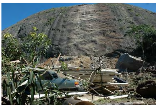
Deslocamento de bloco - Pedra de Itaocaia em Maricá
